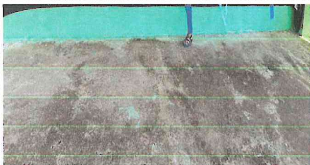
Foto 1: Piso de concreto rústico del escenario deteriorado.
