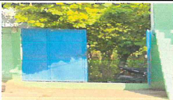
Foto 5: Porton dañado por el paso de los años.
