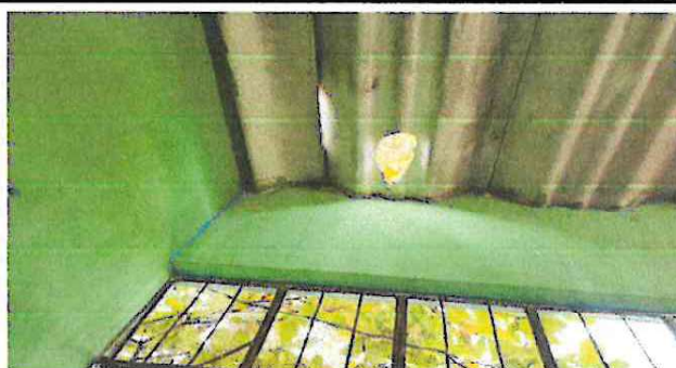
Foto 4: Techo de aulas de duralita, con grandes agujeros.
