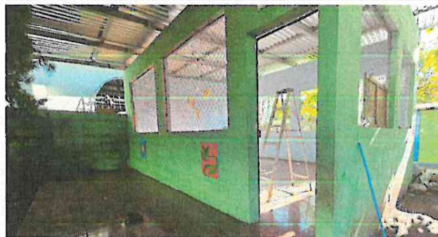
Foto 2: Ventanas de malla en el aula de preprimaria, en mal estado, con agujeros y cuando llueve se inunda el aula.
